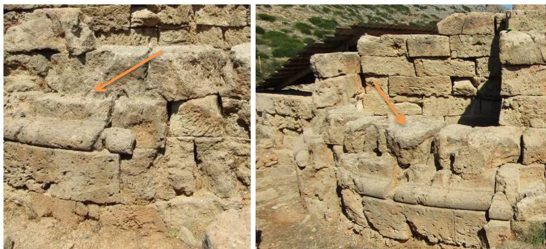
Εικ.76: Οι σοβαρά αλλοιωμένοι ανώτεροι σωζόμενοι λίθοι του Ν τμήματος του πύργου φέρουν έντονη διάβρωση και δεν συνίσταται η αποσυναρμολόγηση τους. Προτείνεται η επί τόπου αποκατάσταση της οριζόντιας άνω έδρας τους με την συμπλήρωση συμβατού κονιάματος (Πηγή: προσωπικό αρχείο).
