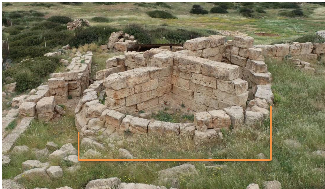
Εικ.72: Το Ν και ΝΑ μέρος του κυκλικού πύργου όπου απαιτείται η αποσυναρμολόγηση και ανάταξη τουλάχιστον του 4 ου , του 5 ου και μικρού μέρους του 6 ου δόμου. Το ίδιο μέρος θα πρέπει πρώτα να ανασκαφεί έως την έδραση στον βράχο (Πηγή: Λήψη με UAV από τον Κλήμη Ασλανίδη).
