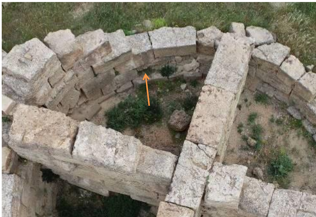
Εικ.74: Για την αποκατάσταση του λίθου που δηλώνεται στην φωτογραφία δεν ενδείκνυται η περιττή αποσυναρμολόγηση πολλών λίθων. Αντ' αυτού προτείνεται η συγκόλληση in situ (Πηγή: Λήψη με UAV από τον Κλήμη Ασλανίδη).
