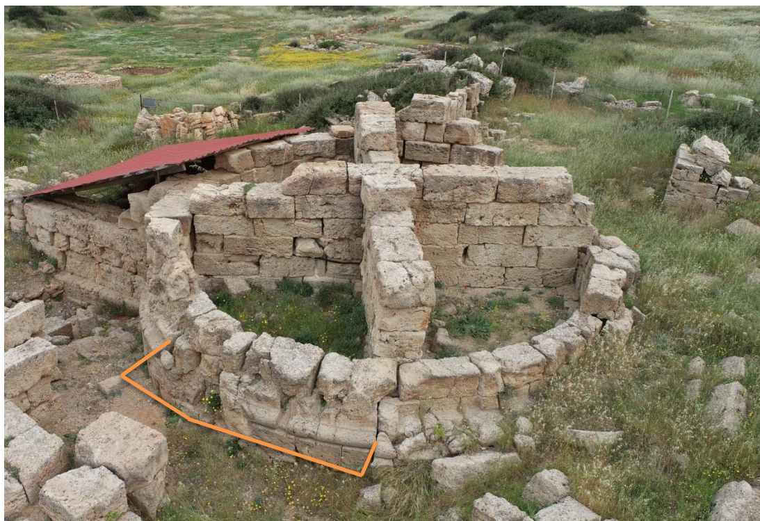
Εικ.77: Η αποσυναρμολόγηση στο τμήμα αυτό δεν αποτελεί επιλογή. Προτείνεται η επί τόπου αποκατάσταση της οριζοντιότητας της άνω έδρας με συμπληρώσεις από συμβατό κονίαμα (Πηγή: λήψη με UAV από τον Κλήμη Ασλανίδη).
