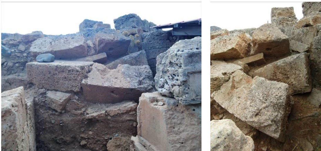
Εικ.89: Τουλάχιστον δύο λίθοι έχουν που ολισθήσει από το Βόρειο τμήμα του πύργου (Πηγή: προσωπικό αρχείο).
