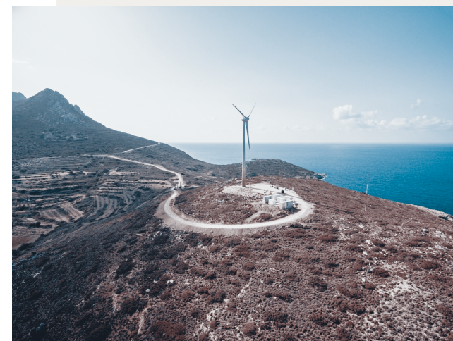
Εικόνα 30: Η ανεμογεννήτρια του υβριδικού σταθμού
