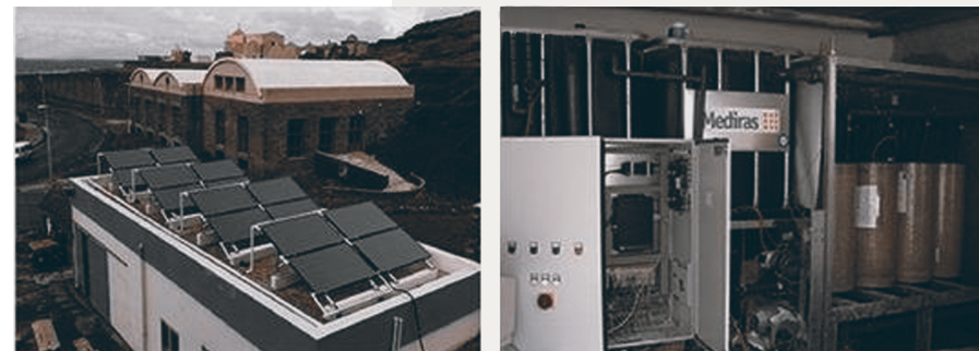
Εικόνα 34: Οι φωτοβολταϊκές εγκαταστάσεις οροφής και οι γεννήτριες πετρελαίου του θερμοηλεκτρικού σταθμού
