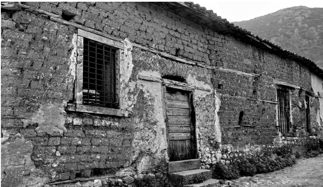
Εικόνα Α.54 Δόμηση με ωμόπλινθους και ξυλοδεσιές . http://www.amfissapress.gr/index.php/2011/02/02/3602/ Η πράσινη αρχιτεκτονική των Ταμπάκικων. Φεβρουάριος 2011.
