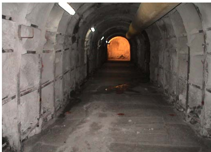
Εικόνα 1.11: Αποστραγγιστική σήραγγα στο αριστερό αντέρεισμα (ΑΕΓΕΚ, 2003).
