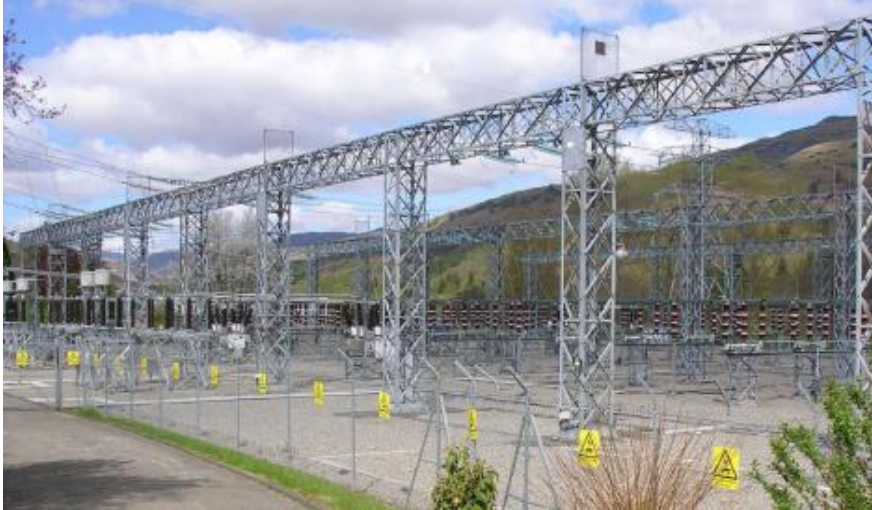
Σχήμα 1.11: Υποσταθμός Υψηλής Τάσης
