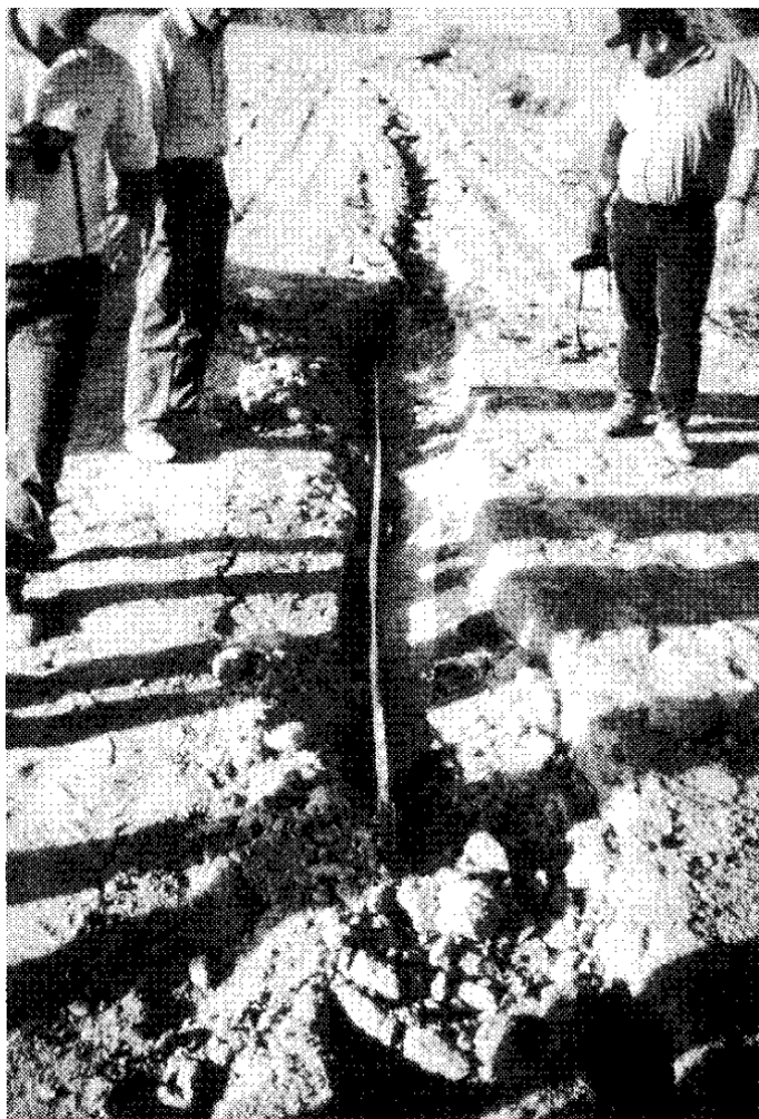
Σχήμα 2.3. Ρωγμή στη γεωμεμβράνη στεγάνωσης η οποία εκδηλώθηκε μετά τον σεισμό του Northridge (1994) στο Χ.Υ.Τ.Α. Chiquita Canyon στην περιοχή C (Matasovic et al., 1998a).
