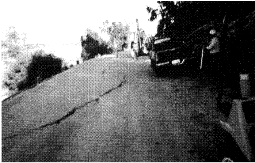
Σχήμα 2.4. Ρωγμές και κατακόρυφη μετακίνηση επί των αναβαθμών του Χ.Υ.Τ.Α. Ο.Ι.Ι., οι οποίες εκδηλώθηκαν μετά τον σεισμό του Northridge (1994) (Matasovic et al., 1998a).
