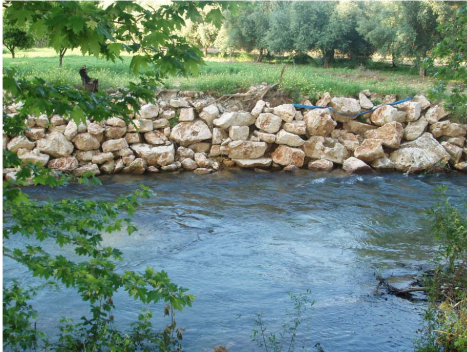
Εικόνα 3. 4. Λιθοδομή κατά μήκος της όχθης του ποταμού Κοιλιάρη, σημείο εκδήλωσης παλαιότερου πλημμυρικού γεγονότος.
