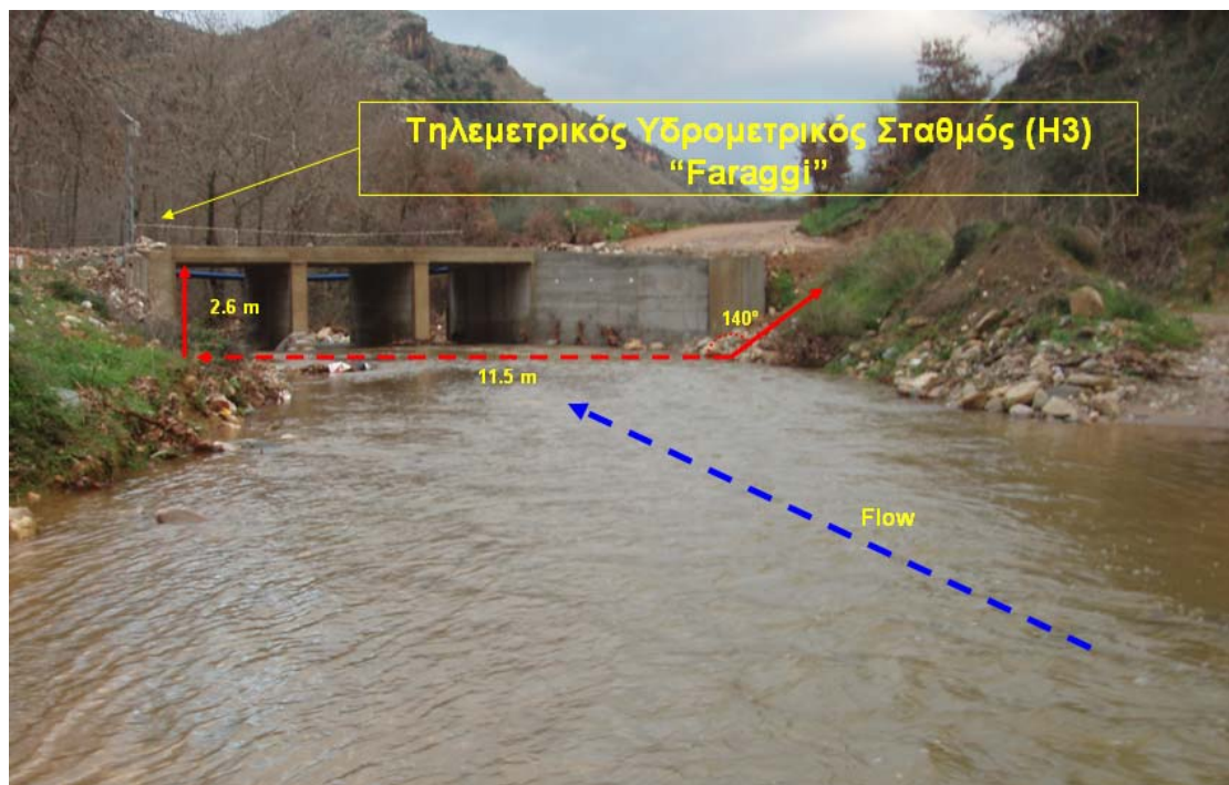
Εικόνα 2. 25. Τηλεμετρικός υδρομετρικός σταθμός Η3 (Φαράγγι) και τα κύρια γεωμετρικά χαρακτηριστικά της διατομής του.
