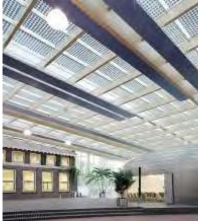
Εικόνα 21 Χρήση Φωτοβολταϊκών σε Κοινόχρηστους Χώρους
