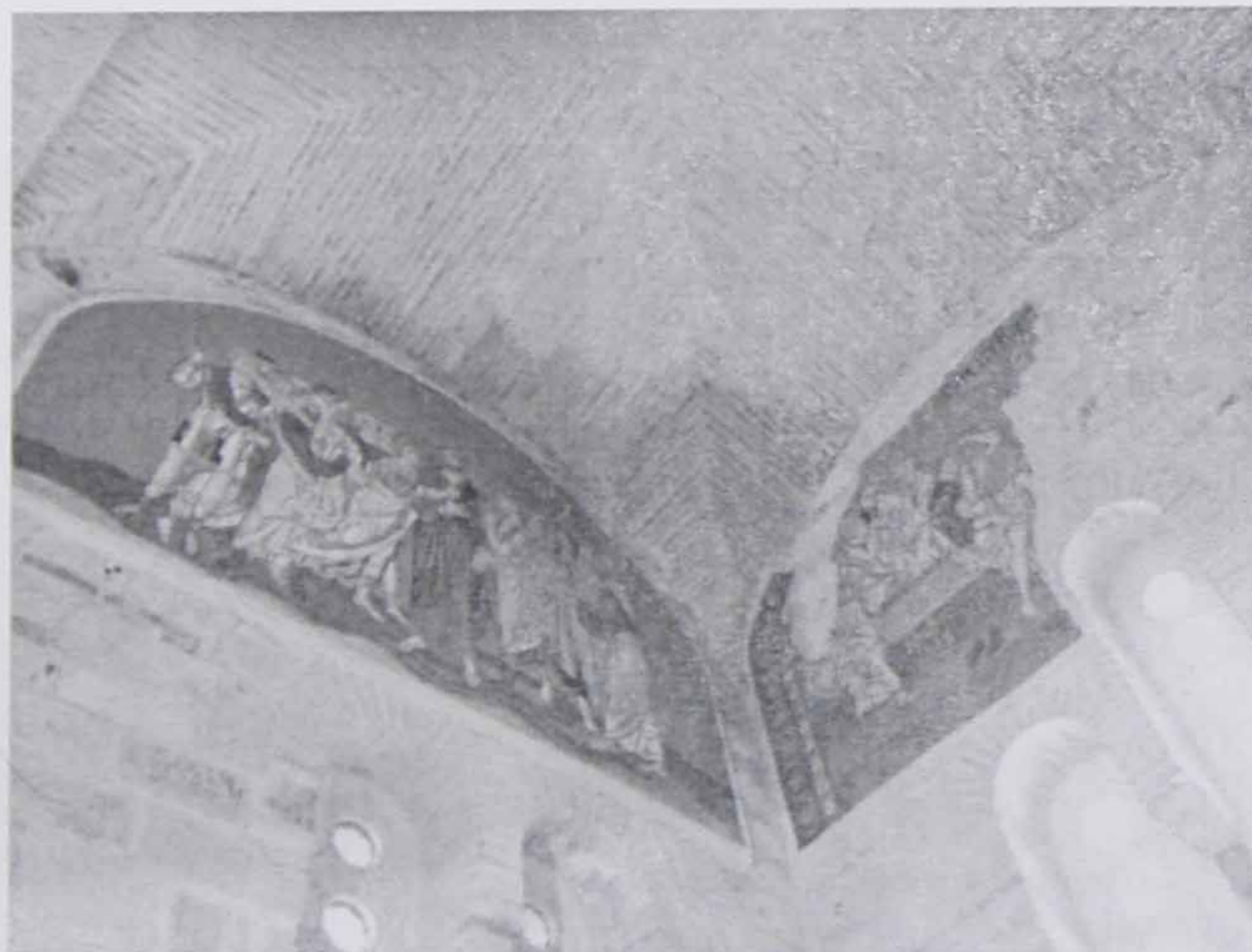
Εικόνα 4: Αποψη της ΒΔ πλευράς του Νάρθηκα, ανάπτυξη υγρασίας στην γένεση του σταυροθολίου
