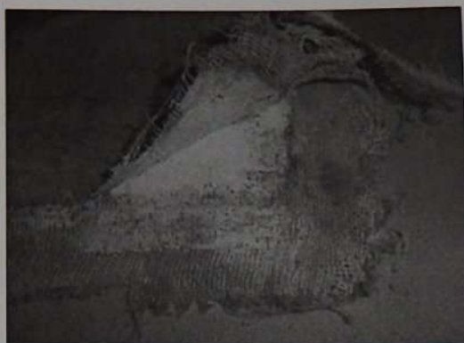
Η συσσώρευση σκόνης στην επιφάνεια του υφασμάτινου υποστρώματος.
