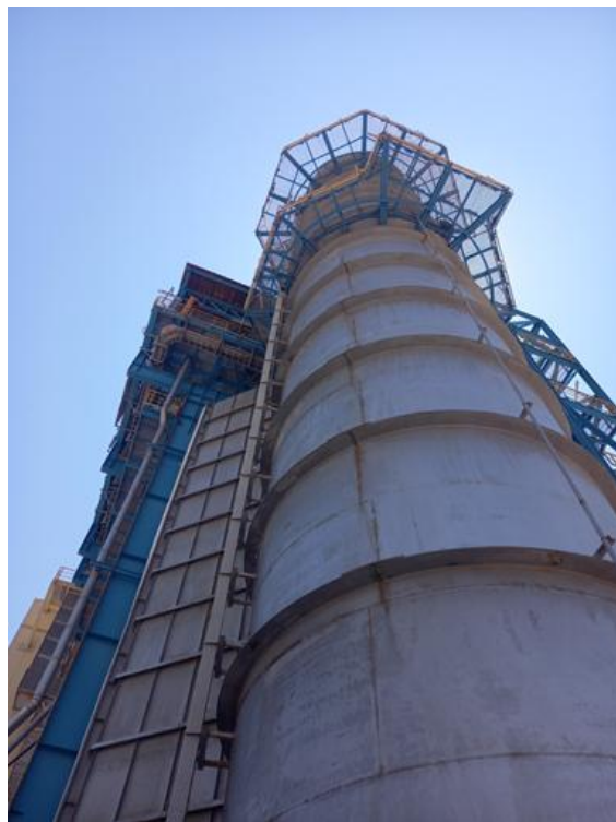
Εικόνα 7. Μονάδα καύσης φυσικού αερίου στον ΑΗΣ Κερατέας-Λαυρίου.
