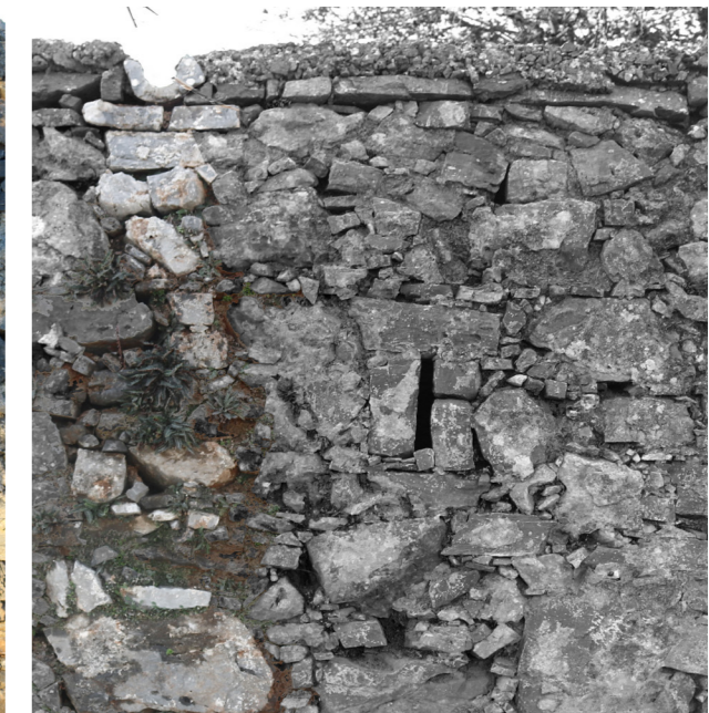
Εικόνα 158. Η Παλιά υδρορροή του κτίσματος.
